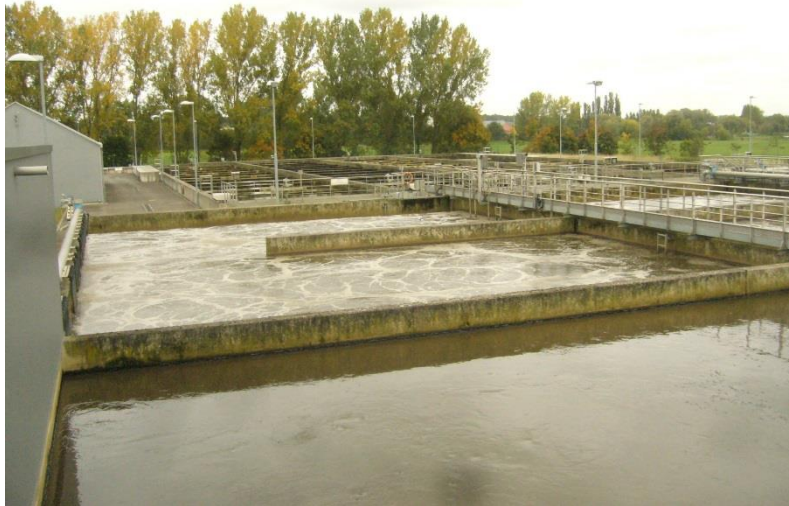
Bassins de décantation
